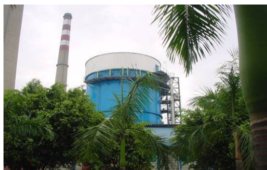
脱硫装置吸收塔
